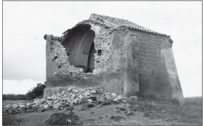
FIGURA 10: Vista de la ermita con el ábside oeste derrumbado parcialmente en 1979
