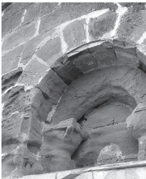
FIGURA 6: La ventana en su estado actual, con un importante grado de erosión
